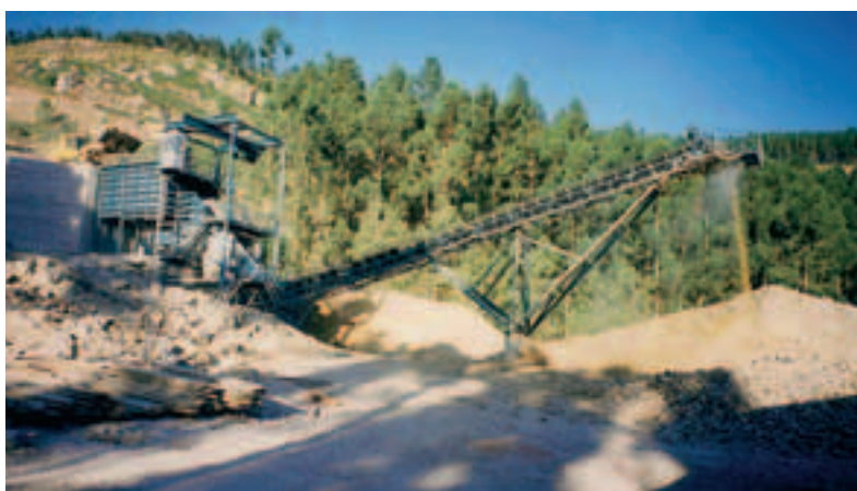
Beladenes Haldenband mit automatisch gesteuertem RAM – die Staubbelastung ist gleich Null.
